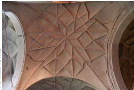
Abb. links: Schadensbild der Netzgewölbe
