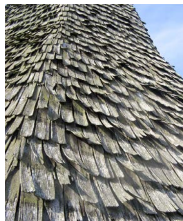
Verschlossene aufgebogene Schindeldeckung des Turms vor der Erneuerung von außen
